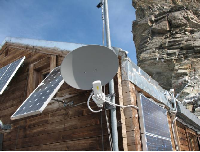
Figura 8 – Nell'ambito del Progetto Interreg PermaDataRoc, è operativa presso la Capanna Carrel una rete di geofoni per il monitoraggio in continuo dell'attività geodinamica del basamento roccioso, che va ad affiancare una strumentazione per la misura del regime termico della roccia, installata da ARPA Valle d'Aosta.
